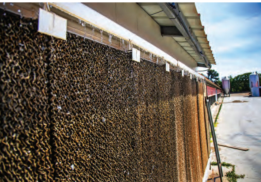
◆ Panells evaporatius de cel·lulosa per refrigerar una nau de pollastres.
