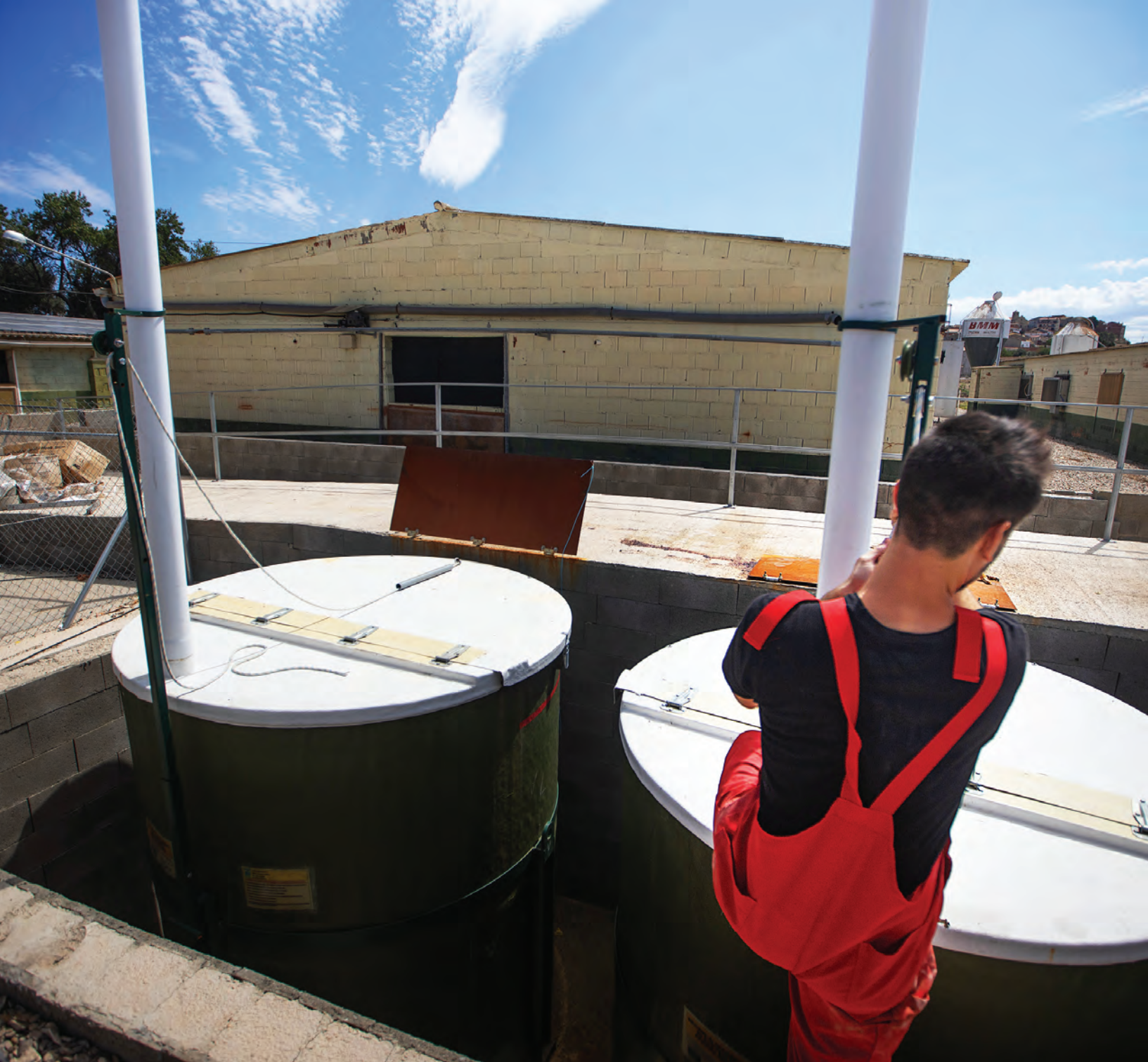
◆ Un treballador d'una granja de Puiggròs tanca els dipòsits de cadàvers, accessibles també des de l'exterior per a la seva evacuació.
